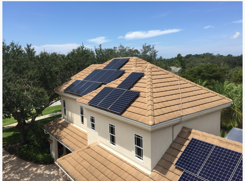
Mirasol Rooftop Solar
